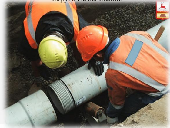
Инженерные коммуникации в городском округе Семеновский
