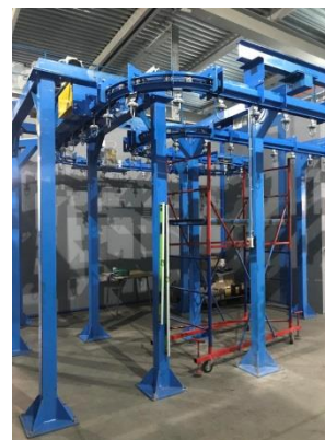
Новая линия порошковой окраски ОАО ЛМЗ
